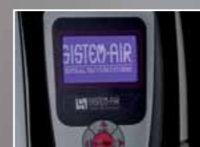
Wartungsanzeige an der Saugzentrale
